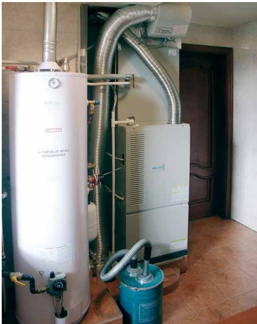
Rys. 2. Najczęściej stosowanym źródłem ciepła w prezentowanym systemie jest nagrzewnica powietrza na gaz ziemny lub płynny
